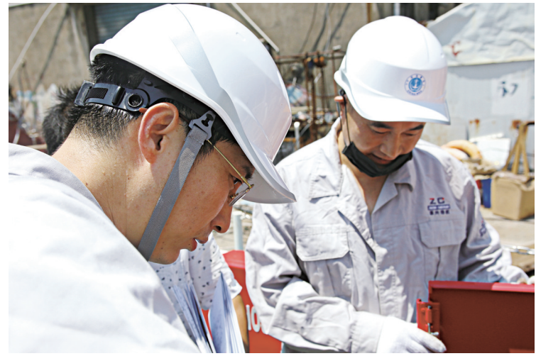
14时 廖正勇和杨洪明在25米沿海公务艇上检查二氧化碳灭火系统。
