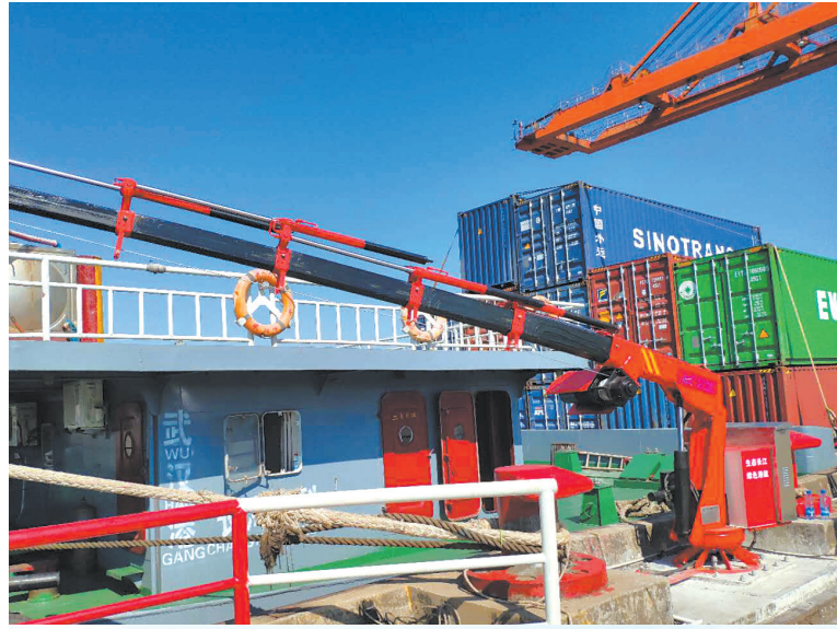
▲岸电设备提升装置。
