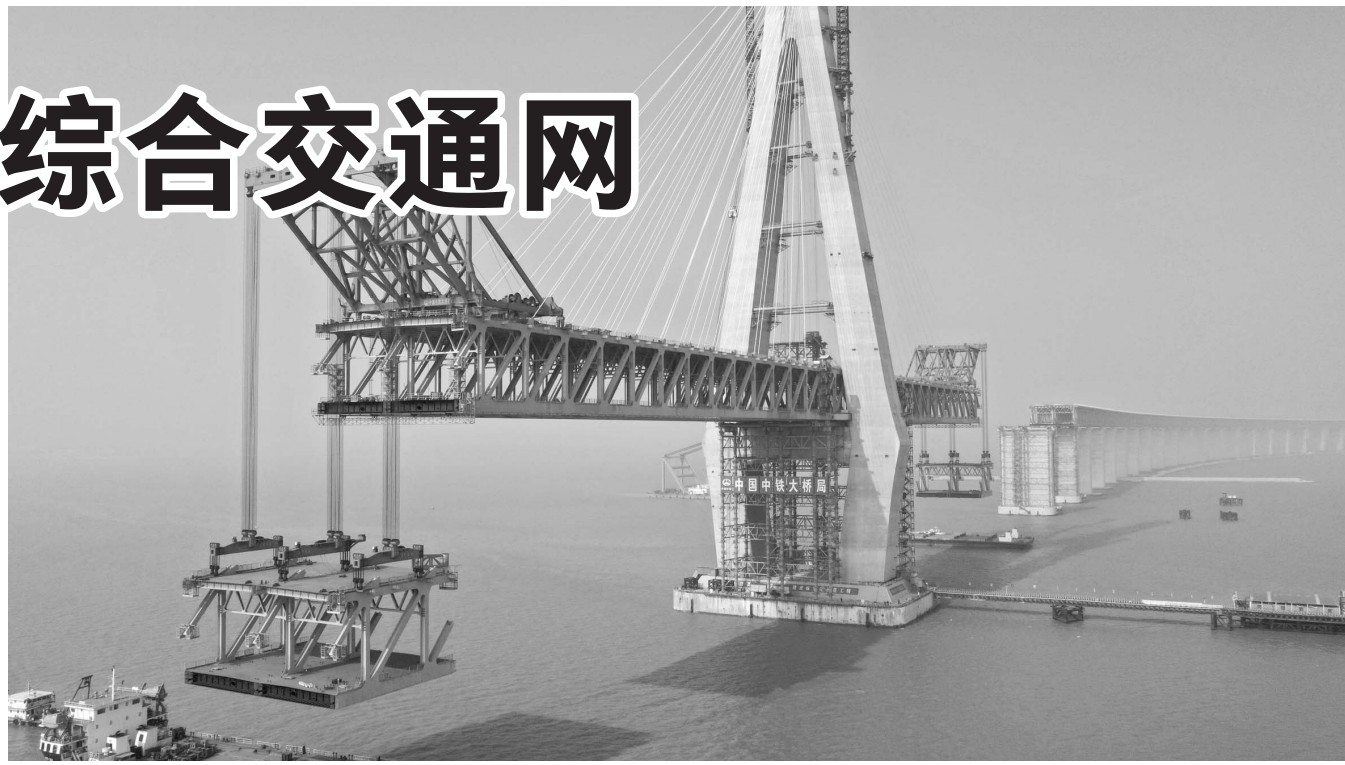
沪通长江大桥新年首轮大节段钢梁双悬臂吊装。江苏省交通运输厅 供图
