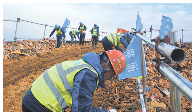
春节期间,中建筑港信江双港航运枢纽项目施工现场一片繁忙景象,各项工作有条不紊地开展着。为保障进度,项目部员工主动放弃休假,参加项目春节抢工。 李辉飞 摄
