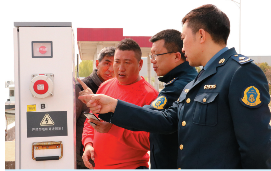
3月27日,受小潮河闸大量排水影响,连云港市新沂河船闸停航,造成待闸船舶积压。当地船闸管理所派出志愿服务队及时为船民提供用水、用电等生活服务。图为工作人员指导船民使用岸电系统。董才涛 摄
