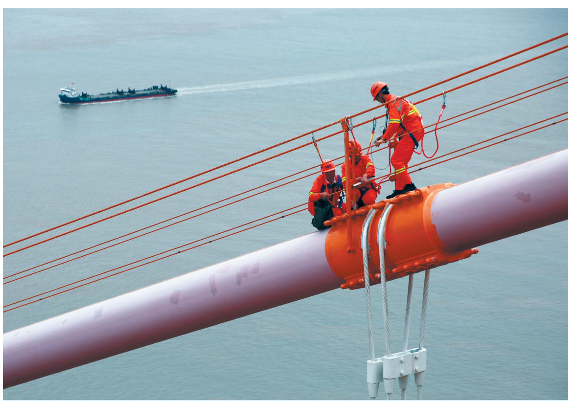
5月28日,浙江舟山跨海大桥之一的西堠门大桥上,技术人员在高达180米的吊索上进行防腐涂装维修,而另一侧主缆上的索夹检查也在紧张进行。为维护桥梁安全稳定运行,从5月初开始,浙江省交通投资集团有限公司的养护人员启动对西堠门大桥的大“体检”,主要包括主缆维修养护、吊索检修、锚碇内部检查等。
