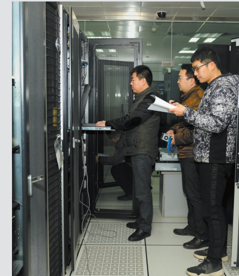
数字航道主中心机房。
