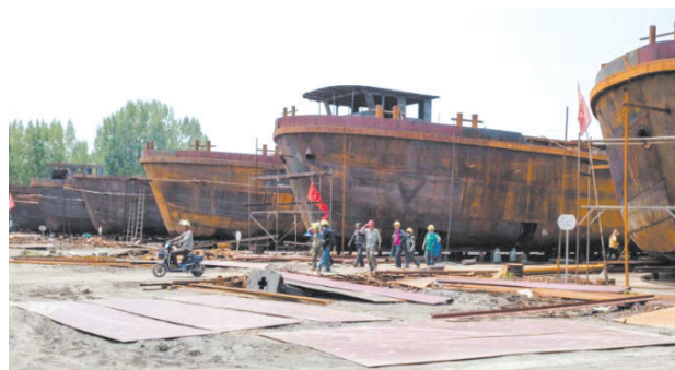
▲微山马口造船厂的工地上，几艘在建大船一字排开，因为天气炎热，工人的工作时间为早晨6时到中午12时。图为正午时分，工人们经过忙碌的工作后准备下班回家。
