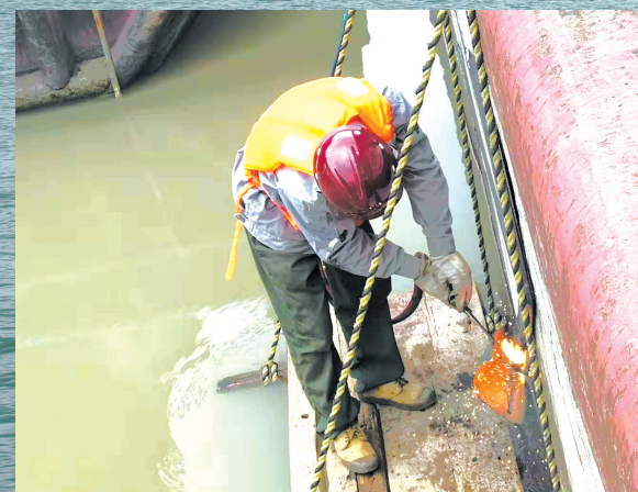
▲船闸养护工人正在处理闸室墙上突出钢板，防止对通航船舶造成伤害。
