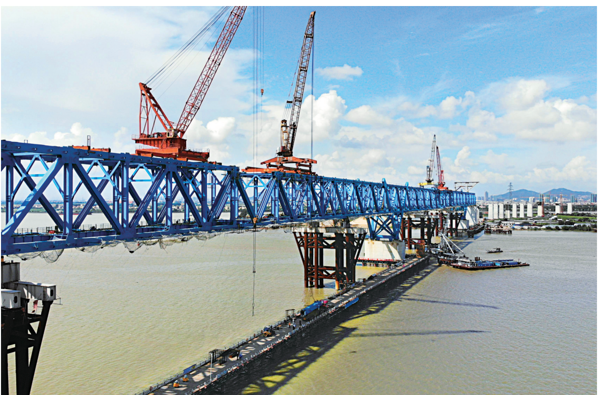
7月26日,作为国家重点铁路项目广州南沙港铁路的控制性工程,洪奇沥水道特大桥率先启动合龙靠近大桥西端的合龙口,西合龙口成功“对接”后,将启动东合龙口施工,预计8月20日前可完成大桥整体合龙。该桥主桥总长998米,采用连续两跨360米的钢桁梁柔性拱技术,建成后将成为国内乃至亚洲同类型最大跨度桥梁。
