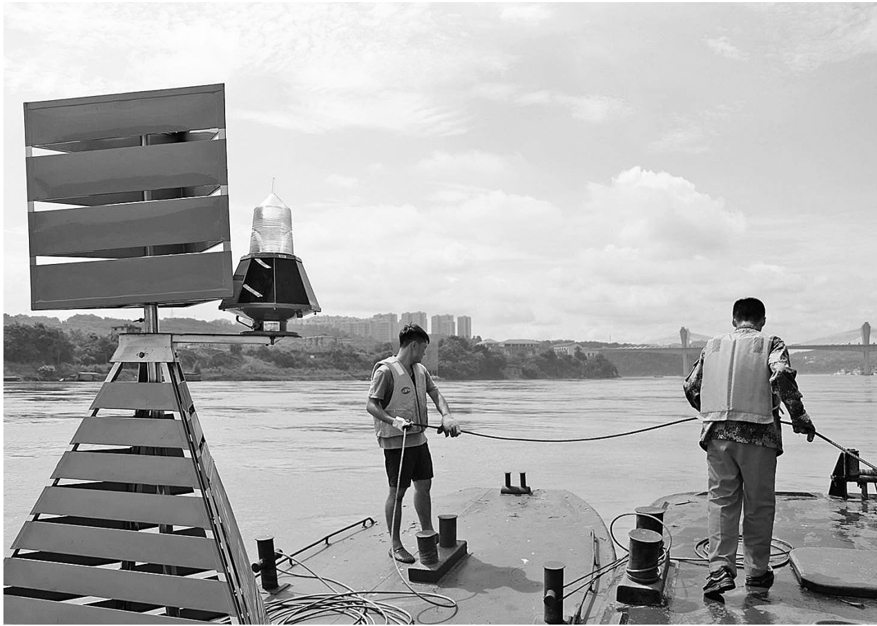
8月2日，四川泸州地区局部气温达37℃以上，船艇甲板温度达70℃。长江泸州航道处和合江航道处职工冒着高温酷暑及时调整和更新桥区航道航标，保证汛期航道安全畅通。
