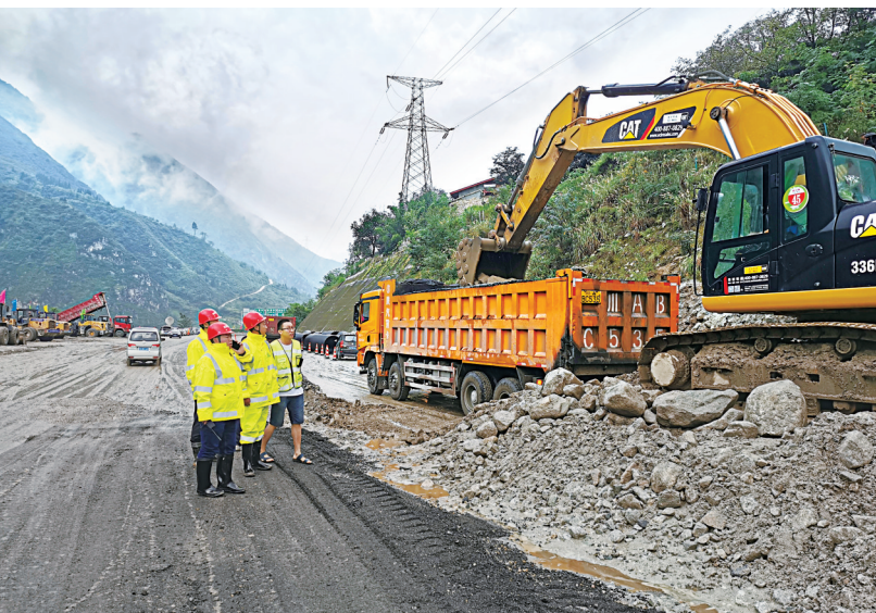
图为高速公路交通执法人员正在受灾现场指导道路抢通。
