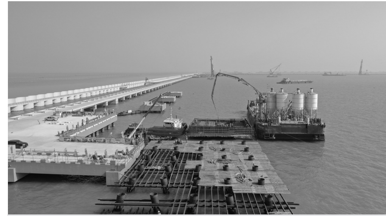
3月19日,连云港市徐圩港区的盛虹炼化一体化配套港储项目码头工程完成了项目复工以来的第72根大管桩沉桩施工,其累计浇筑混凝土6次,共计716立方米。据悉,该项目建成后,将使盛虹石化园区集疏运条件更加便捷,大幅降低物流成本,为优化连云港市石化产业基地产业联动发挥积极作用。
