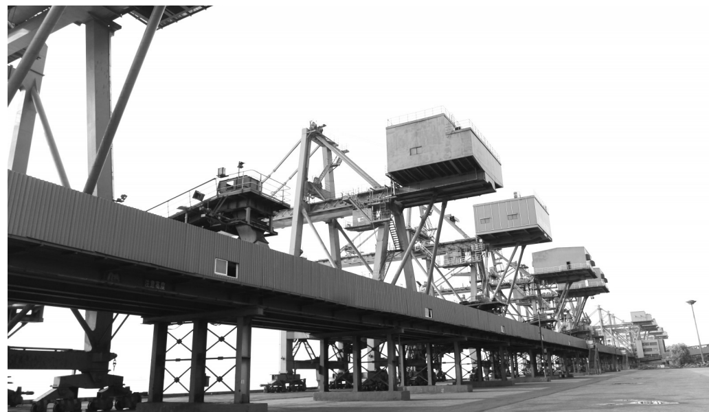
码头皮带机防尘罩。安徽港口集团马鞍山港口公司供图
