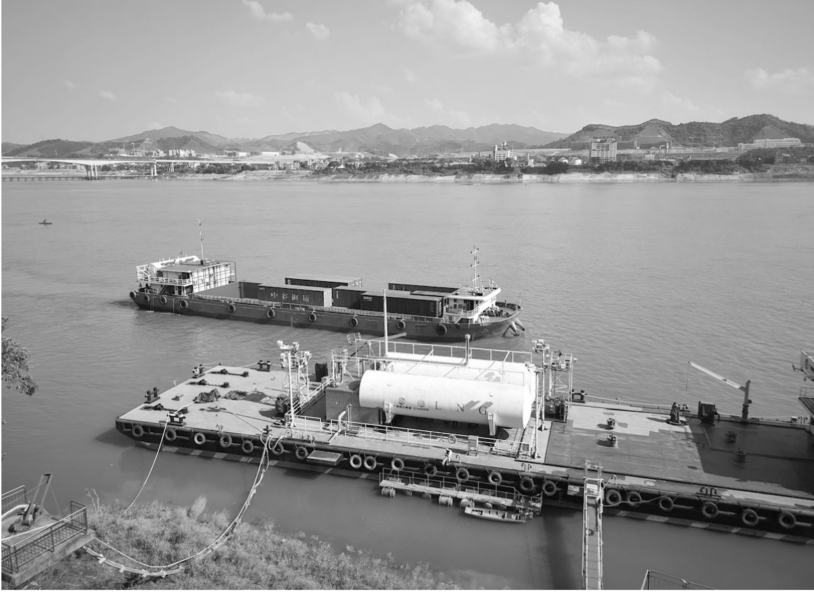
西江干线LNG应用示范项目首座加气站——梧州扶典水上加气站。罗春艳 摄
