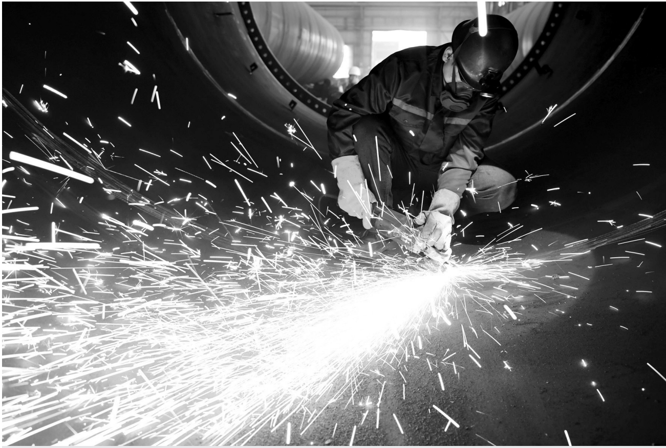
2月8日,江苏省太仓港经济技术开发区,在苏州天顺新能源科技有限公司生产车间内,电焊技术人员正在焊接出口海外市场的海上风电塔筒设备。新年伊始,以生产海上风电、陆上风电塔筒设备为主的该公司全面开工,为全年实现26万吨风电塔筒设备的生产任务保订单、稳产量。 计海新 摄
