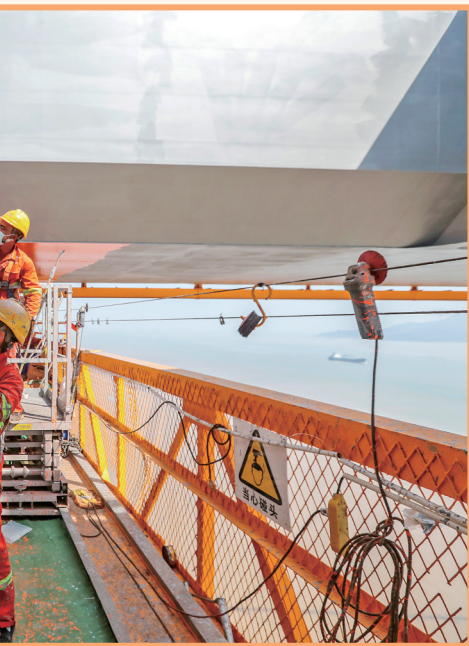
连日来,舟山气温都在35度以上,太阳直射下温度更高。7月12日上午,桥梁养护工人身穿厚重的工作服,在狭小的桥梁桁车上为舟山西堠门大桥钢箱梁进行打磨除锈、涂刷油漆,为这座世界级大桥“更衣换装”。 姚峰 林莹莹 摄
