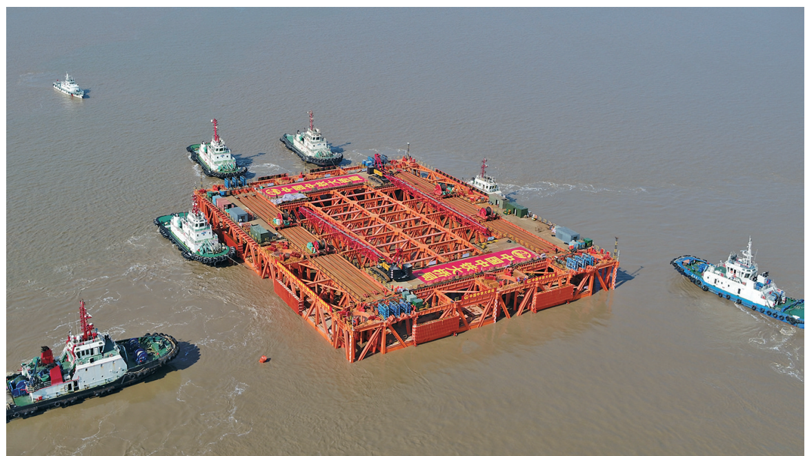
2月16日,在舟山海事部门和舟山引航站共同护航下,甬舟铁路西堠门公铁大桥5号墩自浮式钻孔平台经过约8小时作业浮运到位。该平台长130米、宽100米、高11米,重达7600吨,平面尺寸13000平方米,相当于31个标准篮球场大小。本次浮运为世界桥梁建设史上最大体量的桥梁结构浮运作业。
