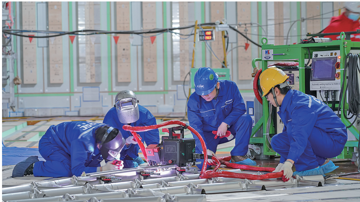
2月23日,全球首座GST陆上薄膜型全容罐——河北河间LNG调峰储备库项目正式交付运营。
