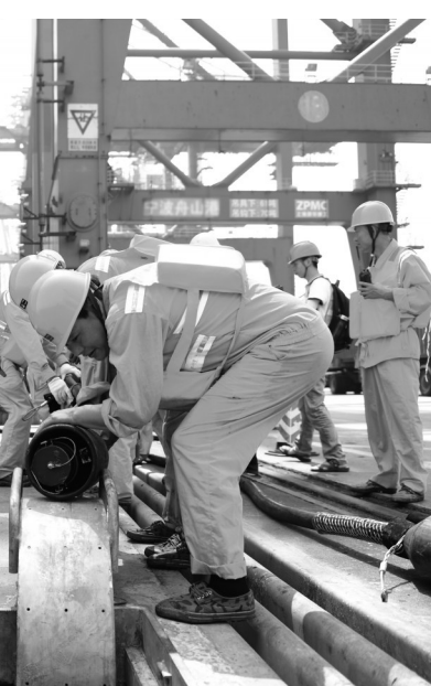
船舶岸电接电现场。曾叙砚摄
