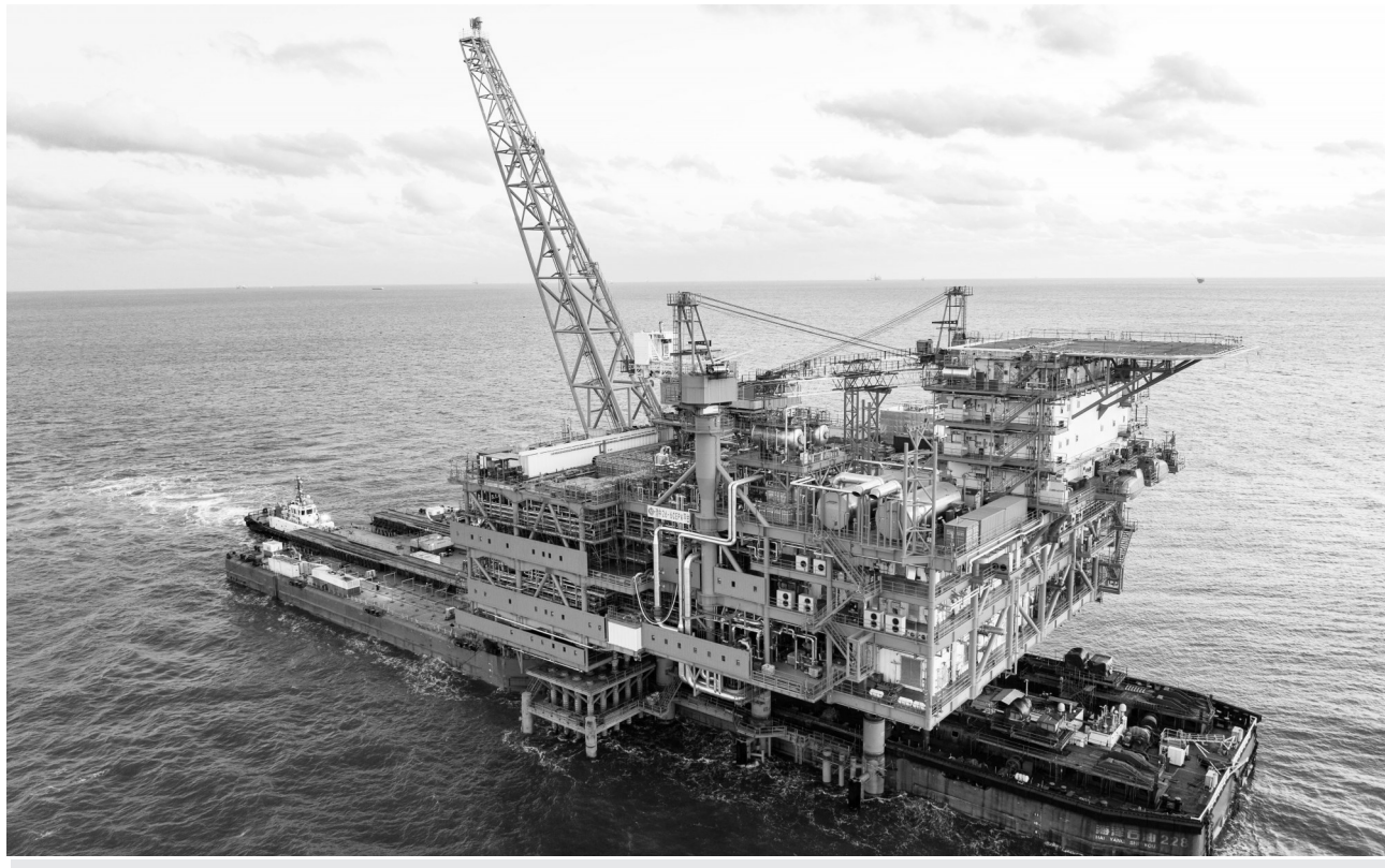
11月28日，由津企海油发项目(一期)中心平台在渤海南部海域完成浮托安装，项目建设对推动渤海油田上产4000万吨、保障国家能源安全具有重要意义。任佳丽/文 李浩玮/图
