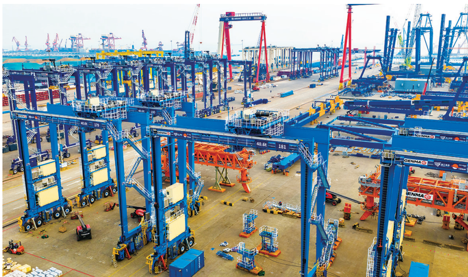
1月25日,江苏太仓港经开区一港口机械设备制造企业技术人员正装配出口海外的集装箱起重设备,今年以来,该类企业的海洋工程装备及港口机械设备产销两旺。 计海新 摄
