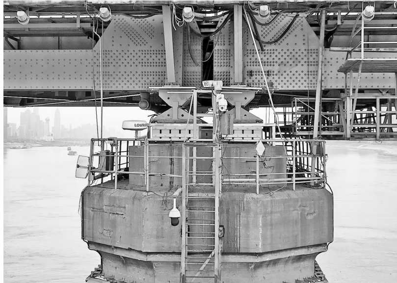
安装在长江大桥桥墩上的预警设备。武汉海事局供图
